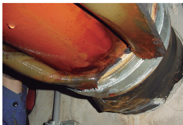
Figura 4: Reclamación de gastos debido al mal aislamiento de una abrazadera ajena al sistema
