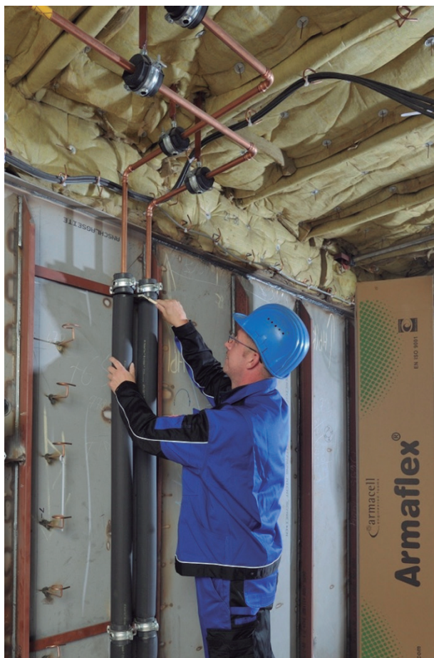
Figura 9: La forma correcta de hacerlo: los soportes para tubería se han instalado de forma profesional y después el instalador de aislamiento simplemente pega el extremo al aislamiento contiguo
