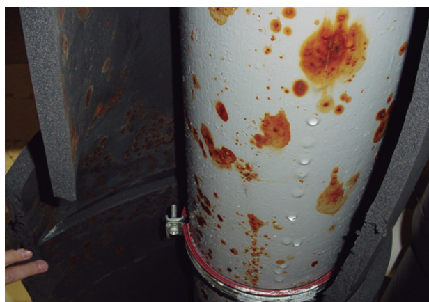
Figura 2: Consecuencias de no aislar correctamente una abrazadera en una tubería de refrigeración
