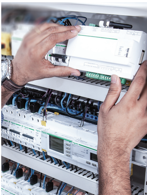
Un cuadro eléctrico inteligente permite la gestión energética del edificio basada en tres pasos: medir y controlar, conectar y ahorrar.
